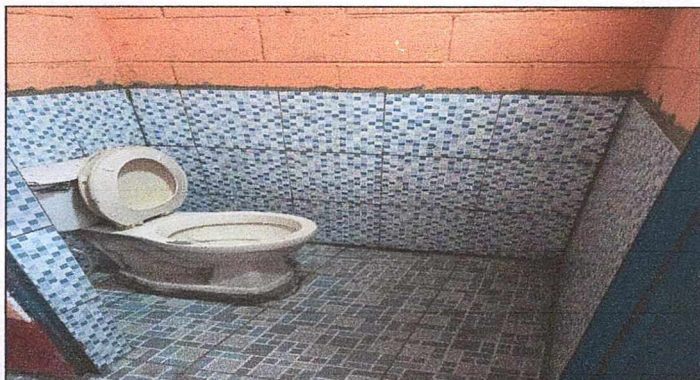
Foto 3: Sustrucción piso, azulejo e inodoro
