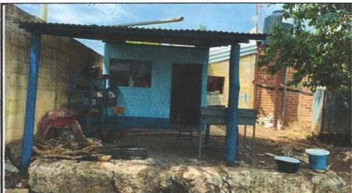
Foto 3: Ingreso a área de cocina en mal estado, banqueta con deterioros.
