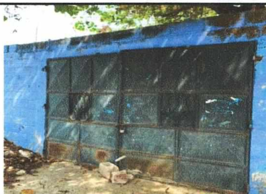
Foto 4: Portón de ingreso deshabilitado por desperfectos
