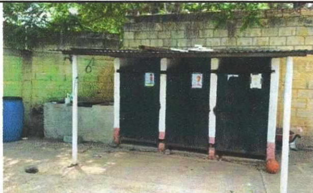
Foto 1: Area de Servicios sanitarios en mal estado, se sustituirán en su totalidad.
