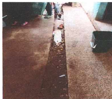
Foto 4: Tubería de 6" para evacuar el agua del area de lavado de manos.
