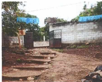
Foto 2: Se necesita fundir una rampa para acceso de los estudiantes y evitar el peligro de una caída por las personas que ingresan al establecimiento.
