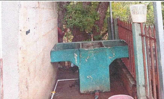
Foto 5: Pila con servicio de drenaje
