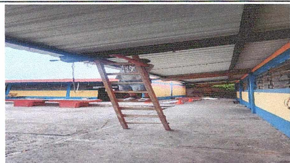
Foto 5: instalación eléctrica en condiciones no adecuadas
