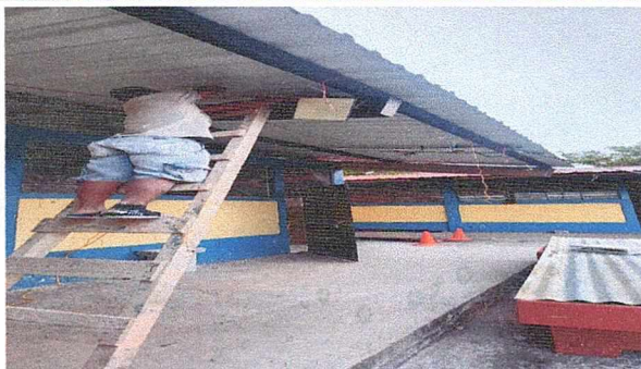
Foto1: Instalación eléctrica en mal estado.
