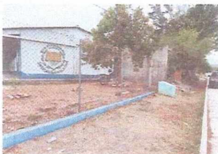
Foto 5: Reparacion de malla, se encuentra en mal estado
