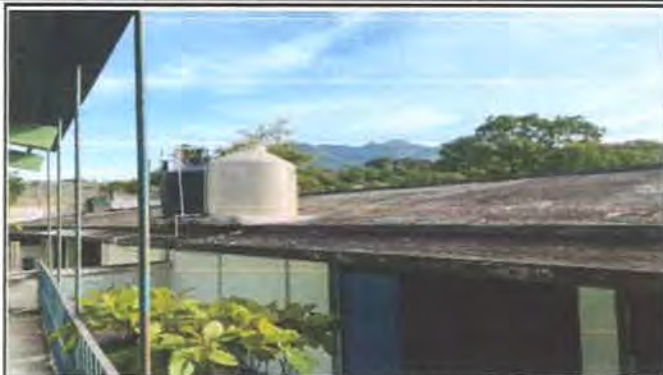
LOSA NECESITA MANTENIMIENTO LIMPIEZA E IMPERMEABILIZACION
