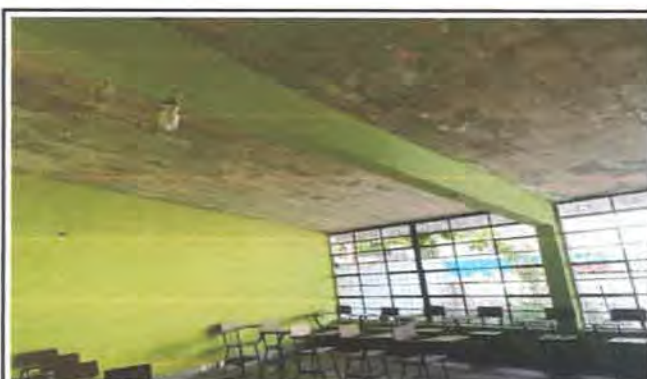
NECESIDAD DE REPELO EN LOSA PARTE INTERNA DE AULAS Y CORREDOR, DESPRENDIMIENTO DE REPELO POR FILTRACION DE AGUA.
