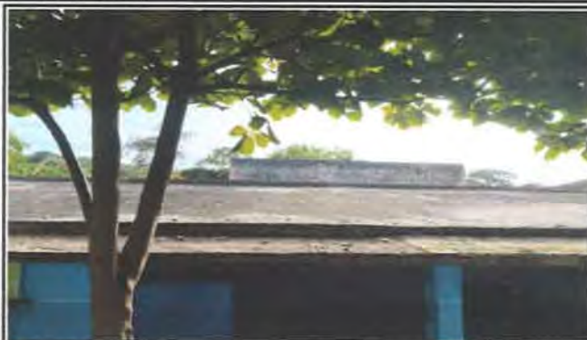
LOSA NECESITA MANTENIMIENTO LIMPIEZA E IMPERMEABILIZACION
