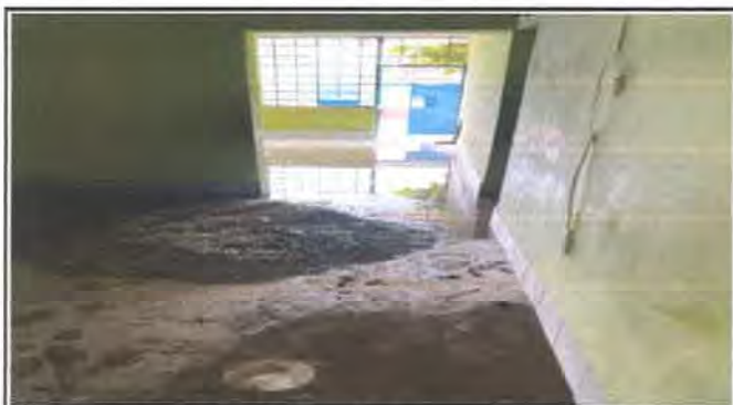
DESPRENDIMIENTO DE REPELO DE PARTE INTERIOR DE AULAS A CAUSA DE FILTRACION.
