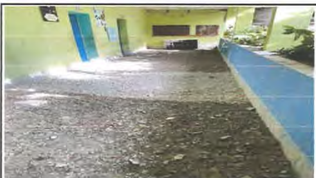
DESPRENDIMIENTO DE REPELO DE PARTE INTERIOR DE CORREDOR A CAUSA DE FILTRACION.
