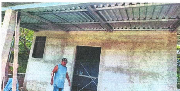
Foto 3: Repello en paredes de la cocina.
