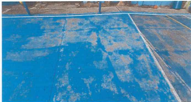
Foto 1: Demuestra el levantamiento de la plancha de concreto.
