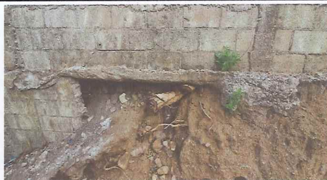
Foto 2: Se observa la gravedad del sacavamiento que existe.
