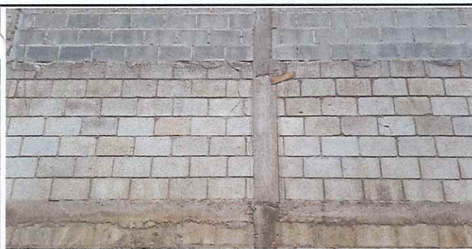
Foto 5: Pared del muro donde empieza la grieta.
