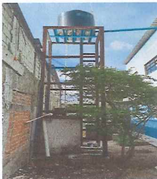
Foto 1: Vista completa de la base del tinaco.
