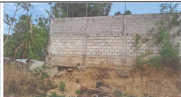
Foto 3: Se observa el área afectada y la que se necesita reforzar.
