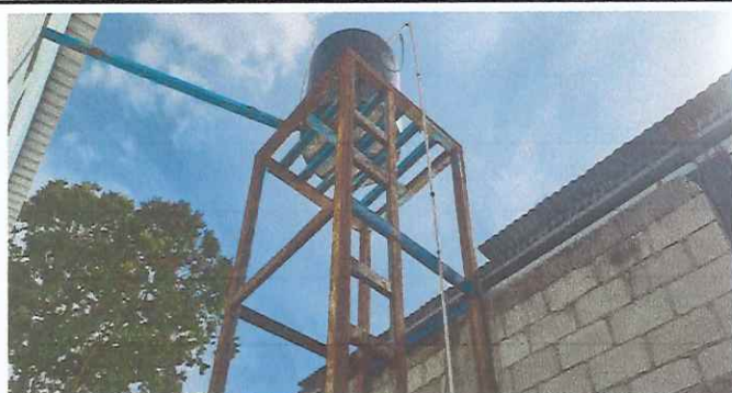
Foto 3: Se observa el deterioro de la base del tinaco.
