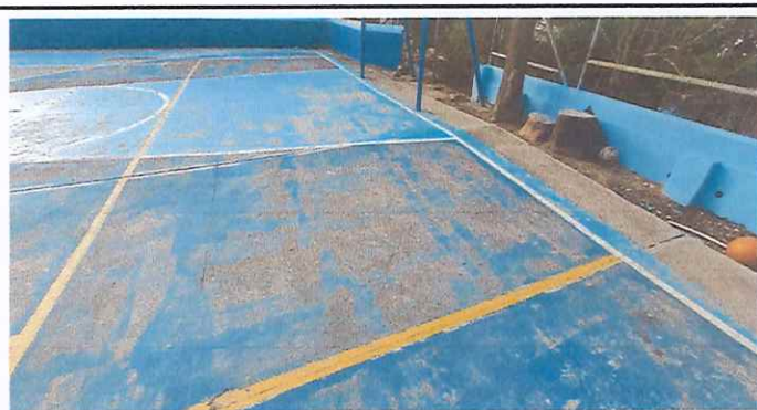
Foto 3: Demuestra el área a sustituir
