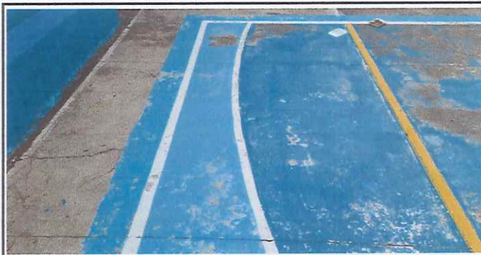
Foto 6: Se ve la grieta que tiene la plancha de concreto .
