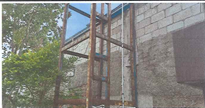
Foto 5: Observamos el desgaste o deterioro de la pintura.
