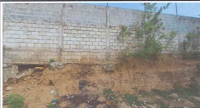
Foto 1: Se visualiza el muro por la parte de atrás observando el sacavamiento que existe.
