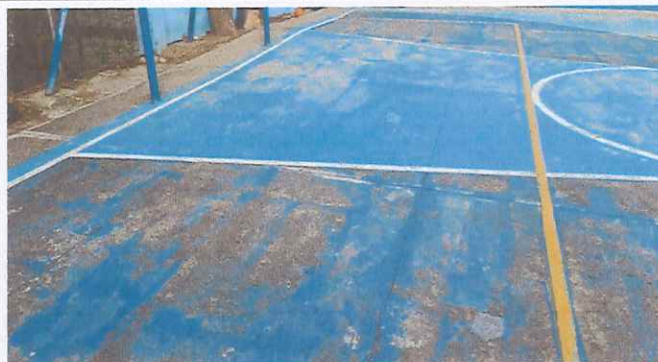
Foto 2: Demuestra el deterioro de la plancha de concreto.
