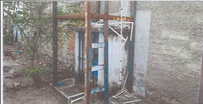
Foto 6: Otro ángulo del estado de la base del tinaco.
