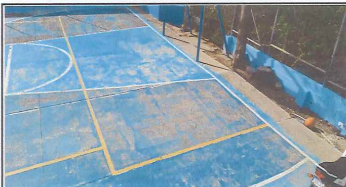
Foto 4: Se ve el área a sustituir que se encuentra levantada y fisurada por las raíces de los árboles.
