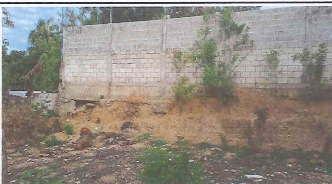
Foto 4: Ampliación del área afectada.
