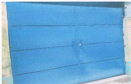
Foto 2: arreglo de porton en mal estado
