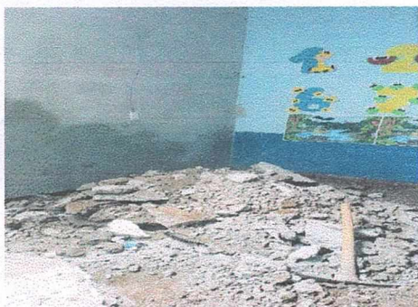
Foto 3: arreglo de aula en mal estado
