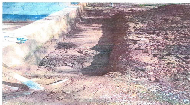
Foto 6. Impermializacion de muro
