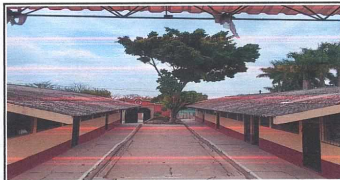
MODULOS DE AULAS CON TECHO DE DURALITA EN MAL ESTADO
