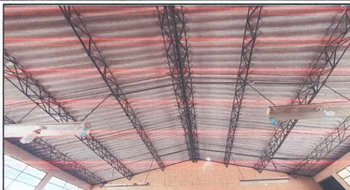
LAMINA DE DURALITA EN MAL ESTADO, SE NECESITA CAMBIO
