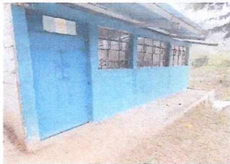
Foto 6: Se observa la carencia de banqueta frente a aula de primaria de la Escuela
