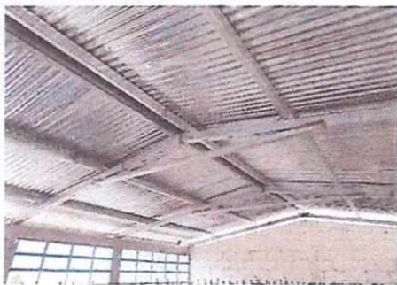
Foto 5: Se observa carencia de instalación eléctrica (iluminación y fuerza) en aula de primaria de la Escuela
