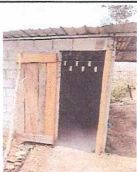
Foto 3: Vista de la puerta improvisada a sustituir en cocina escolar.
