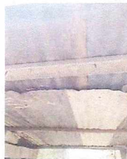
Foto 4: Vista actual de la calidad de techo en cocina y carencia de luminarias.
