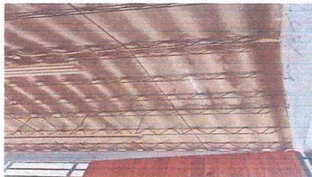
Foto 2: techado dañado del modulo de primaria
