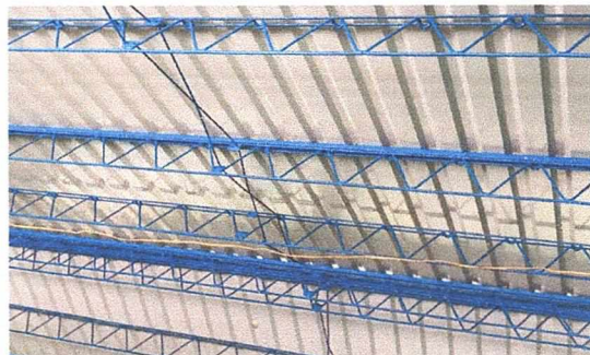
Foto 4: Estructura Tipo Joist a sustituir por estructura de metal en módulo 1.
