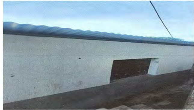
Foto 10. Repello de cocina y bodega
