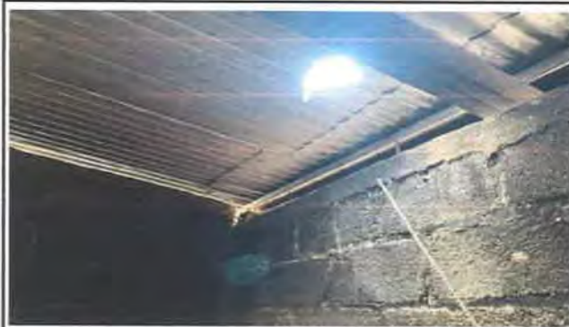
TECHO DE COCINA EN MAL ESTADO
