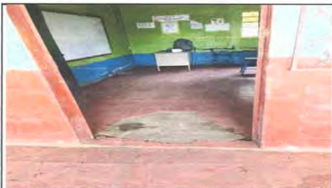
PISO DE AULAS EN MAL ESTADO
