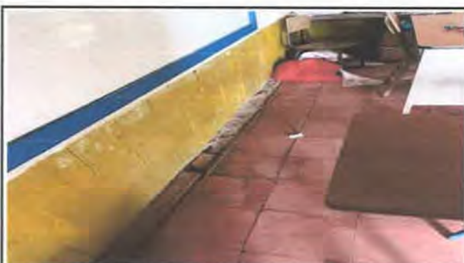
PISO DE AULAS EN MAL ESTADO
