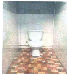
SERVICIOS SANITARIOS Y SUS ACCESORIOS
