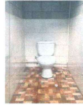
SERVICIOS SANITARIOS Y SUS ACCESORIOS
