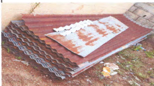
Foto 3: LAMINA RETIRADA DEL TECHO DEL EDIFICIO
