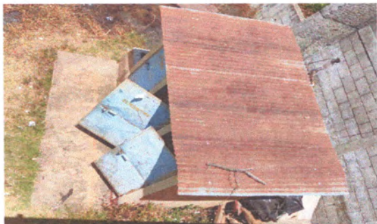
Foto1: SANITARIOS EN MAL ESTADO
