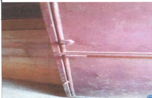
FOTO 2: PUERTAS EN MAL ESTADO
