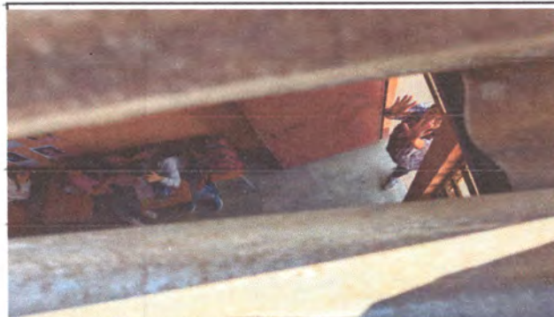
Foto4: LAMINA EN MAL ESTADO
