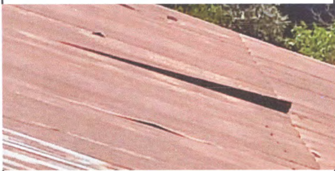
Foto3: LAMINA EN MAL ESTADO
