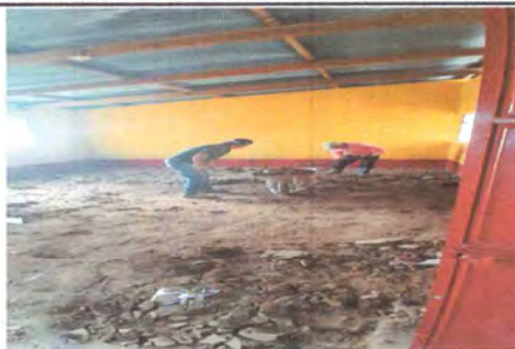
Foto 7: Sustrucción de piso en aula, ya que hay un hundimiento en todo el piso
