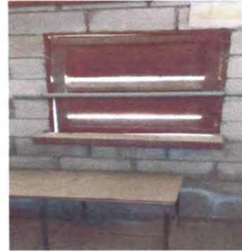
FOTO 2: Sustrucción de ventana de cocina en mal estado.
