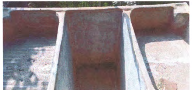
Foto4: Sustrucción de pilas, que presentan un alto grado de deterioro.
