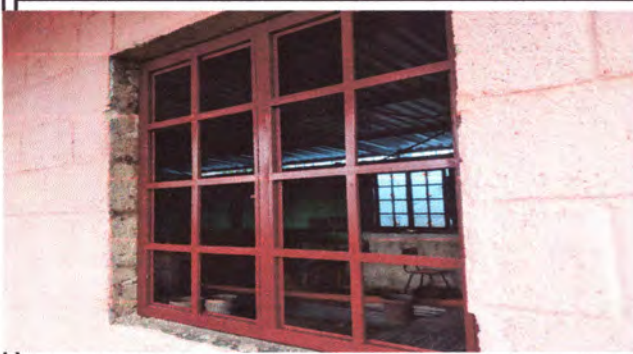
Foto 1: Instalacion de ventana. Falta el vidrio
