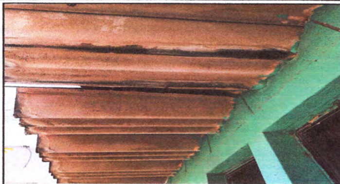
Foto 1: Sustrucción de Lámina
