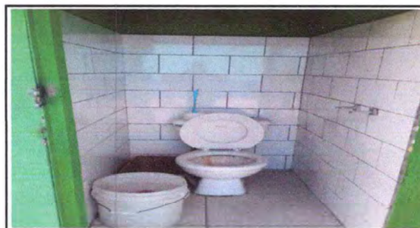
Foto 4: Servicios sanitarios y sus accesorios
