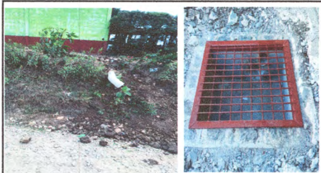
Foto 4: Posterior la tubería del drenaje porque cuando llueve se rebalsa la reposadera porque el diametro del tubo muy pequeño
