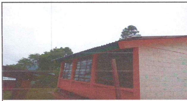
Foto 4: anulación de pintura que se encuentra en mal estado.
