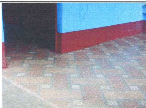
Foto 3: Piso en cocina
