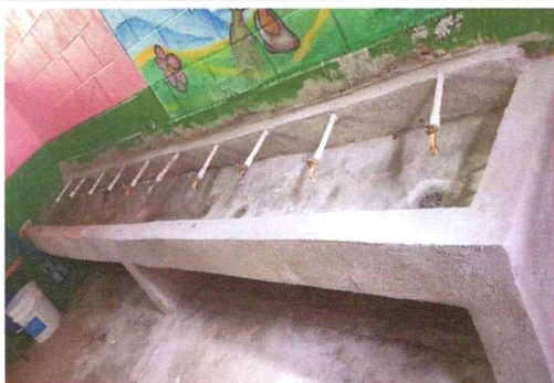
Foto 3: Sustrucción de lavamanos con filtraciones
