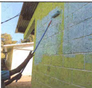
Foto 5: Pintura en paredes
