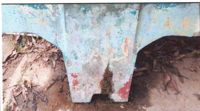
Foto3: DEPOSITO DE AGUA EN MAL ESTADO
