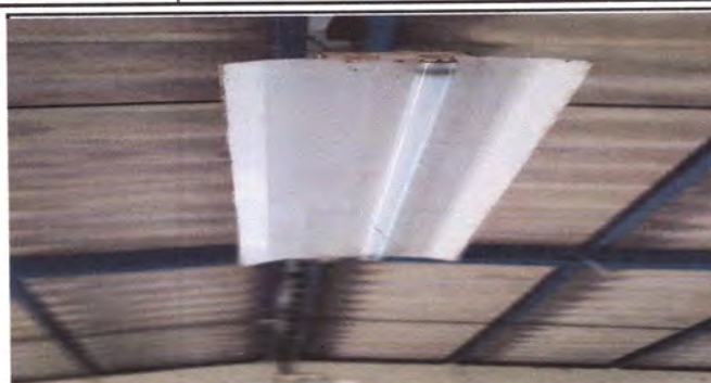
FOTO 2: SISTEMA ELECTRICO EN MAL ESTADO
