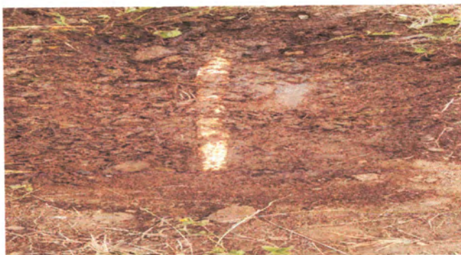
Foto4: DISTRIBUCION DE TUBERIA EN MAL ESTADO
