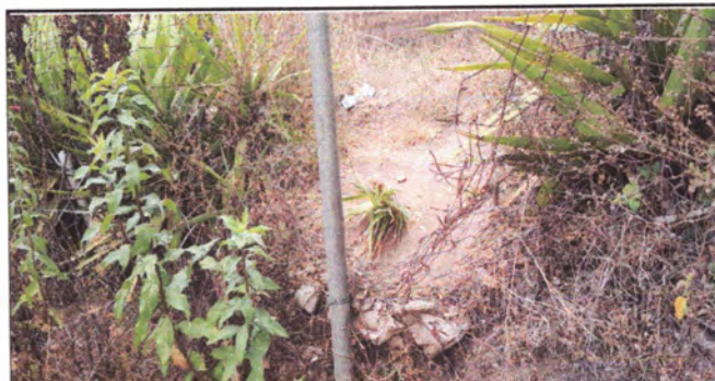
Foto: 6 MALLA PERIMETRAL DESTRUIDA
