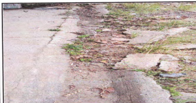
Foto: 5 CUNETA DE CONCRETO DESTRUIDA
