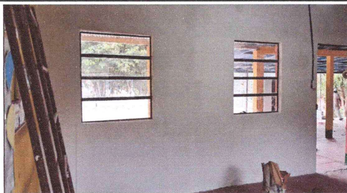
Foto 2: Pared sin repello del aula de preprimaria.
