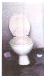
Foto 4: SERVICIOS SANITARIOS Y SUS ACCESORIOS
