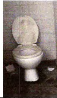
Foto 4: SERVICIOS SANITARIOS Y SUS ACCESORIOS
