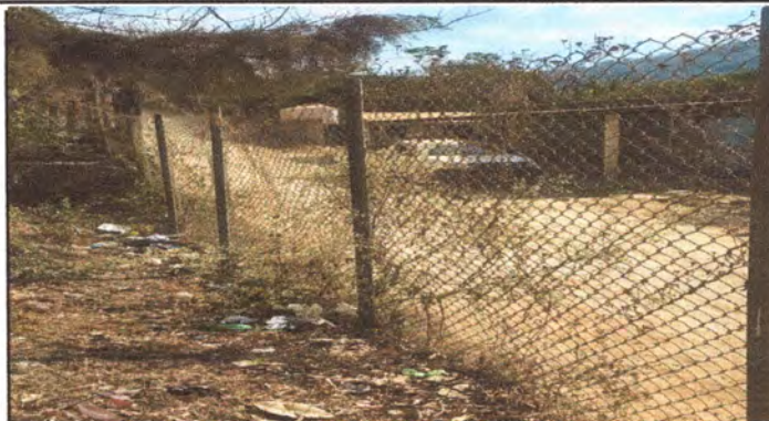
foto 7: La restauración de muro perimetral es necesaria para resguardar la seguridad del establecimiento.
