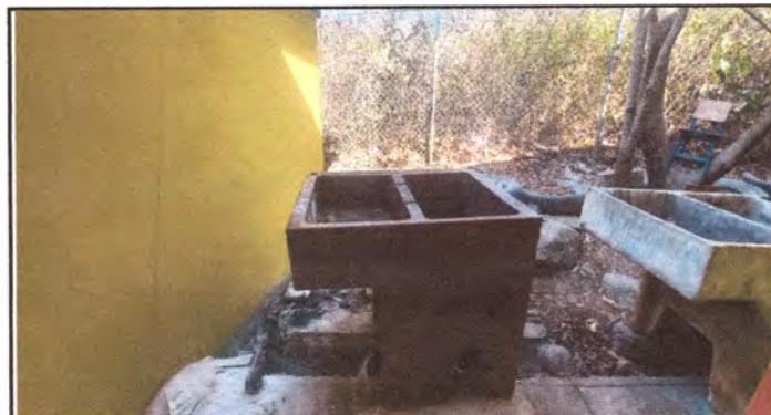
foto 10: La reposición de las pilas es primordial para fortalecer área de cocina.
