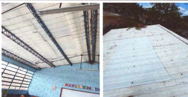
Foto: Láminas dañadas.
