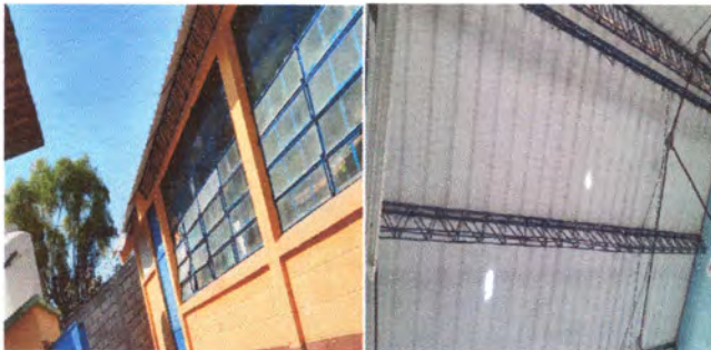
Foto: Láminas dañadas.
