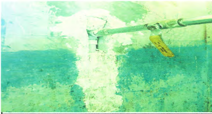
Foto: 6 Duchas y sisema de drenaje colapsados
