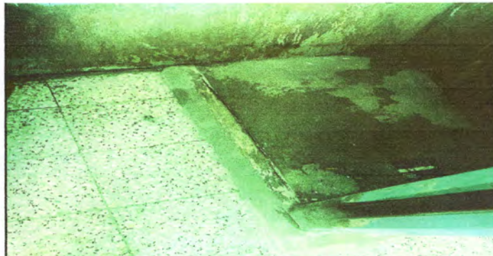
Foto: 6 Duchas y sisema de drenaje colapsados
