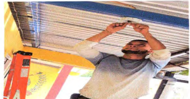
Foto 10: Sistema eléctrico 70% de avance
