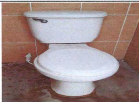
Foto 3: SERVICIOS SANITARIOS Y SUS ACCESORIOS (MANTENIMIENTO)
