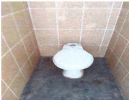
Foto 3: SERVICIOS SANITARIOS Y SUS ACCESORIOS (MANTENIMIENTO)
