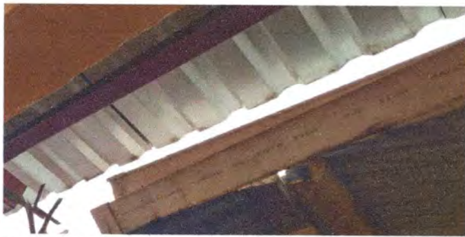
Foto 3: SE SUSTITUIRA EL CANAL MAS BAJADAS.
