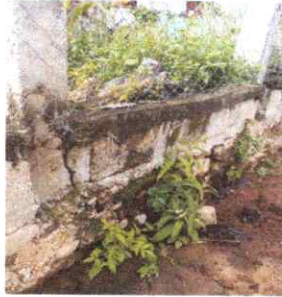
Foto1: MURO PERIMETRAL EN MAL ESTADO
