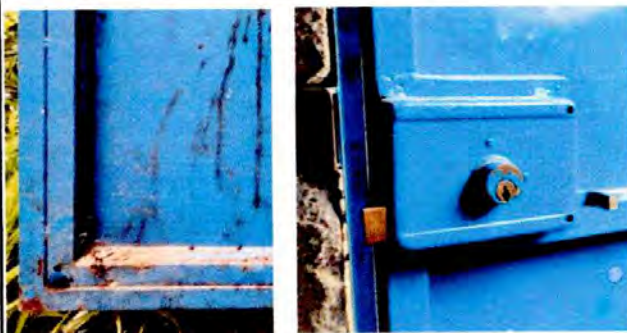
Foto 4: LAS PUERTAS DE LA COCINA Y EL AULA No. 4 ESTÁN CORROIDAS Y PICADAS. LAS CHAPAS ESTÁN SOBADAS
