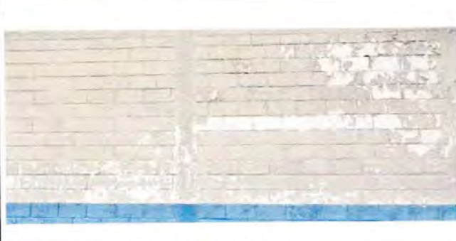
FOTO 8: LA PINTURA ESTÁ DESCASCARADA
