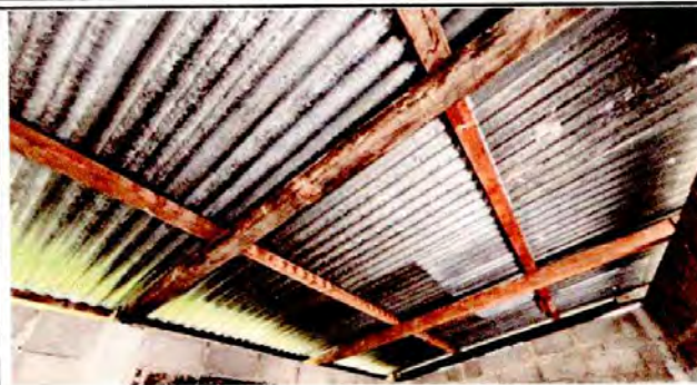
FOTO 2: LA MADERA QUE SOSTIENE LA LÁMINA DE LA COCINA Y COMEDOR ESTÁN APOLILLADAS Y PODRIDAS
