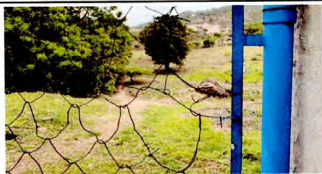
Foto 10: PORTÓN DE INGRESO EN MAL ESTADO
