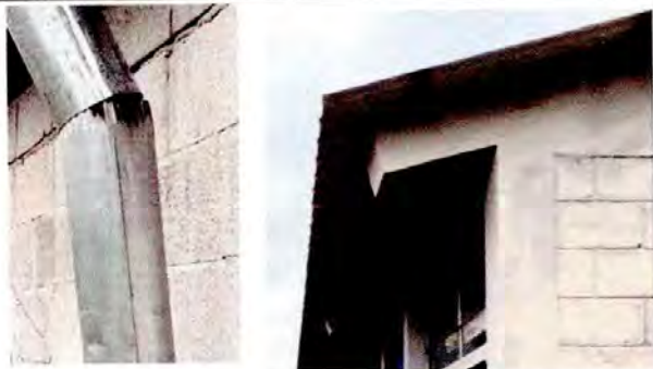
Foto 7: EL CANAL DEL TECHO POSTERIOR SE CAYÓ PORQUE LOS PESCANES IMPROVISADOS NO SOPORTARON
