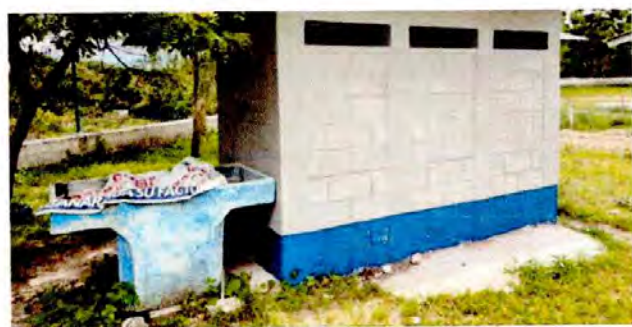
Foto 9: LAVAMANOS SE DESPRENDIÓ DE SU BASE
