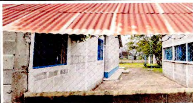
Foto 1: LA LÁMINA DE LA COCINA Y COMEDOR ESTAR PICADAS Y OXIDADAS
