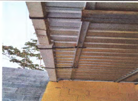
Foto: 6 canales y bajadas de agua fluvial
