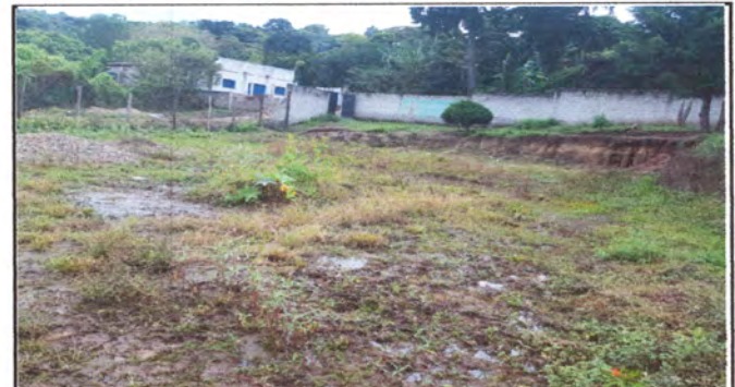
FOTO 4 :SE OBSERVA SUELO ANEGADO Y MURO FRACTURADO
