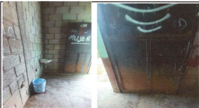
FOTO 7: SE OBSERVA EL MAL ESTADO DE LAS PUERTAS PRINCIPALES DE LOS BAÑOS DE HOMBRES Y MUJERES, TAMBIEN EL DETERIORO DE LOS LAVAMANOS DE AMBOS
