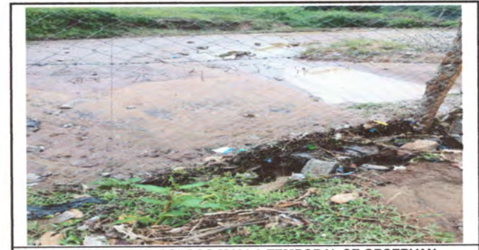
FOTO 6 : COMUNIDAD COLOCO MALLA TEMPORAL SE OBSERVAN SUELOS SATURADOS
