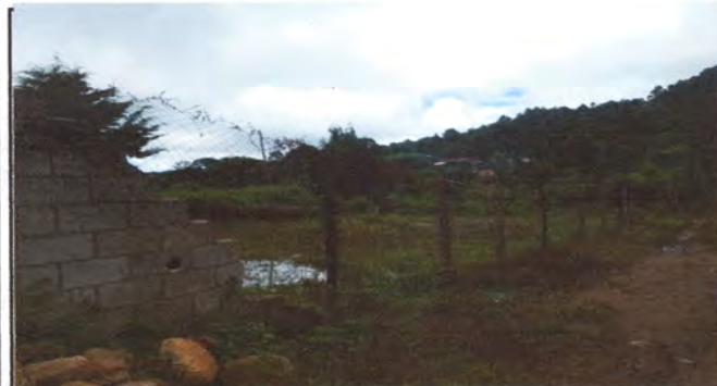
FOTO 3 : MURO ANTERIOR COLAPSO YA QUE NO TENIA DRENAJES NI ZAPATAS
