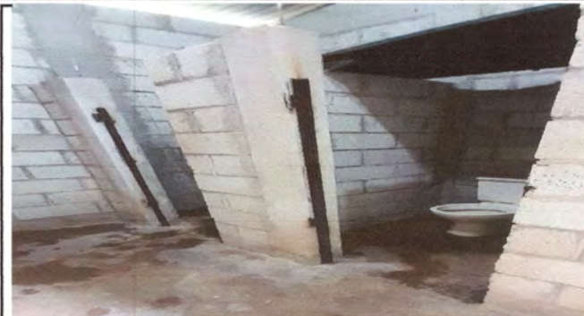
FOTO 8: DETERIORO DE PUERTAS DE LOS BAÑOS Y SANITARIOS DETERIORADOS DE HOMBRES Y MUJERES
