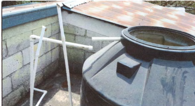
FOTO 10 : ROTOPLAS Y SUS ASCCESORIOS EN MAL ESTADO
