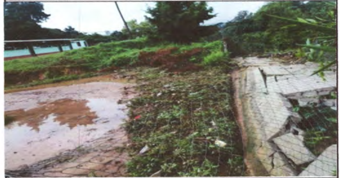
FOTO 2: MURO DE CONTENCIÓN Y PERIMETRAL COLAPSADO, LA COMUNIDAD YA REALIZO LA BASE
