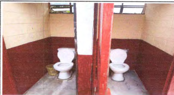
Foto 4: SERVICIOS SANITARIOS Y SUS ACCESORIOS
