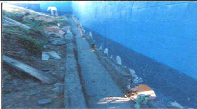
Foto1: SE SUSTITUYE LA CUNETA EN LA PARTE INFERIOR DEL MURO DE CIRCULACIÓN DEL CENTRO EDUCATIVO.
