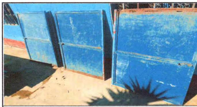
Foto 5: SE SUSTITUYE LAS PUERTAS DEL LOS SANITARIOS, LAS QUE PRESENTAN CORROSIÓN.
